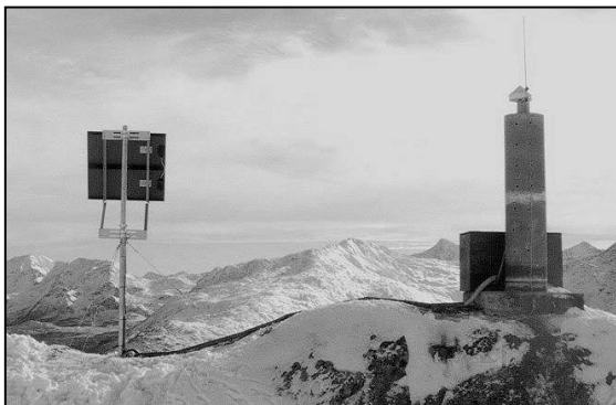
Abb 1: Autonome GPS-Anlage mit Solarstromversorgung
