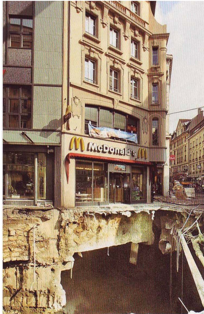
Einsturz des Bohrtunnels für die neue Métro in Lausanne VD 2005.
