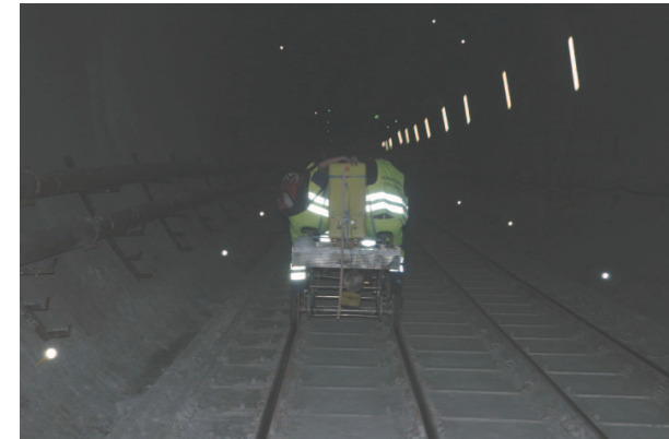
Der Kreisel auf dem Weg zum nächsten Einsatz im Gotthardbasistunnel bei Faido. Quelle: Stephan Schütz
